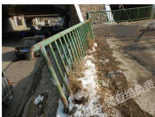
护栏破损、变形
