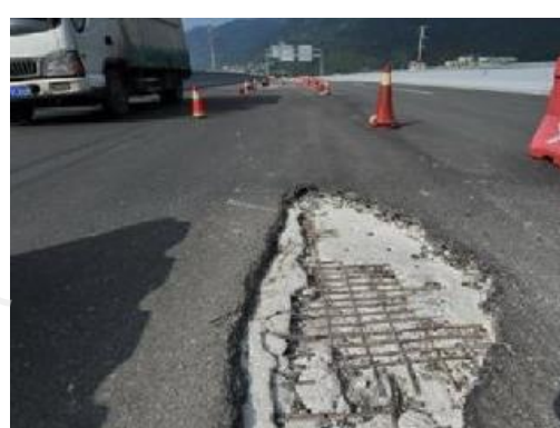
混凝土铺装碎裂
